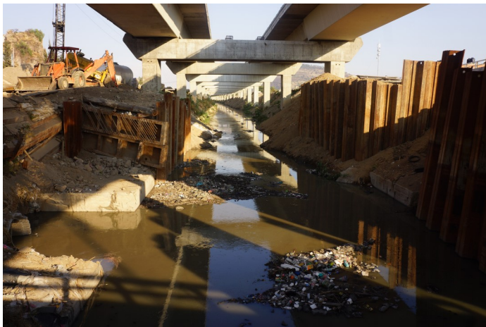
Vista del río de los Remedios, cuyo cauce funge actualmente como canal de aguas residuales. Foto: Jenifer Segura 2013.
