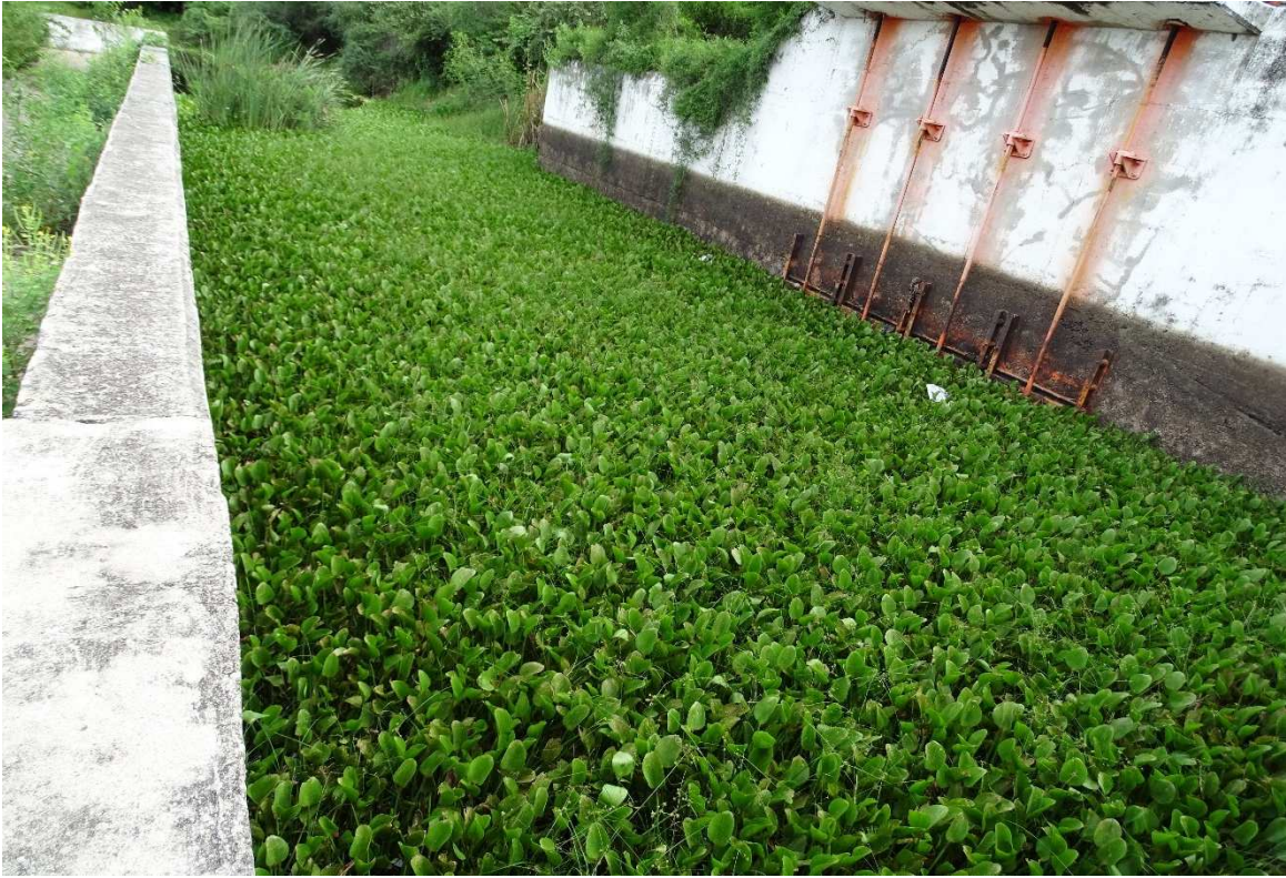
Foto 237. Compuertas de la derivadora
