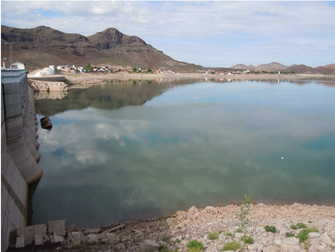
Foto 52. Presa libre de PAEI
